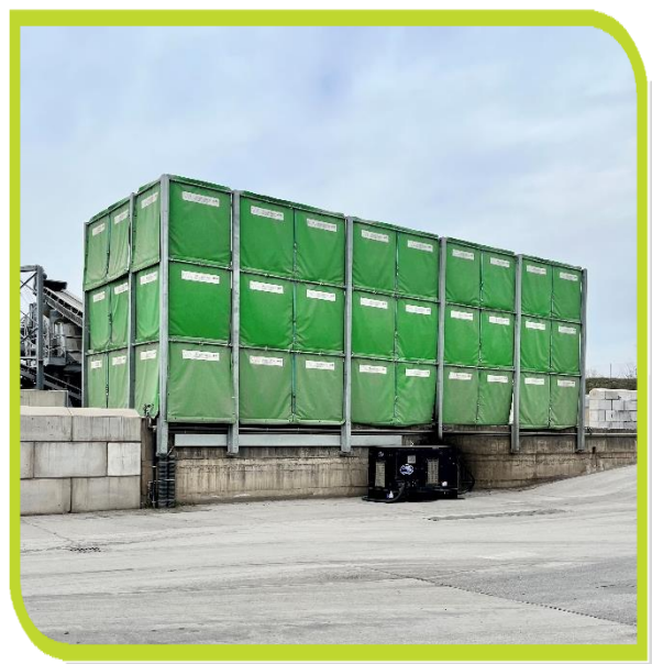
Schermatura impianto frantumazione inerti
